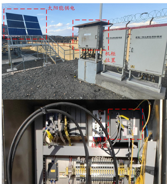
图7 测试安装环境实景图
